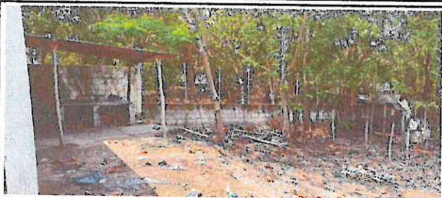
Foto 1: Continuidad de muro perimetral, por falta de construcción
